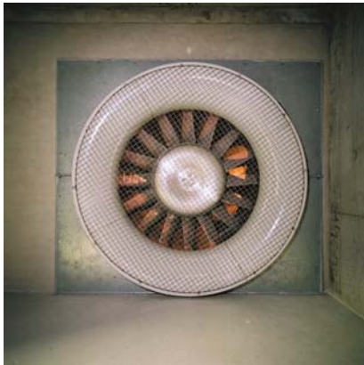
Применение в вентиляционных установках
